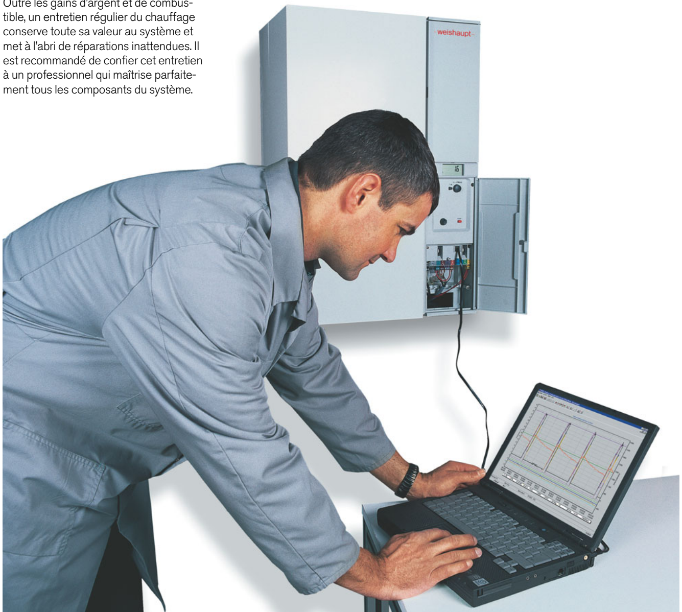
L'installateur peut consulter et analyser toutes les données de fonctionnement.
