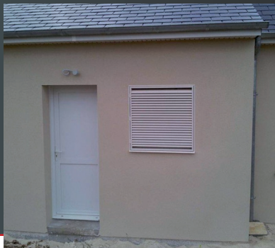
Pompe à chaleur vue de l'extérieur
